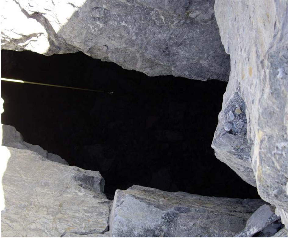
图19 三号采空区的孔口塌陷实景照片
